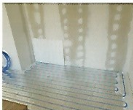
Vloerverwarming, essentieel voor warmtepomp
