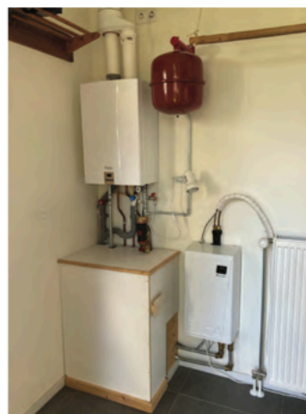
Hybride verwarming: een CV ketel in combinatie met een warmtepomp.
