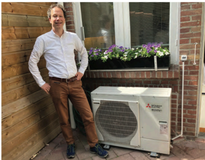
De 'buitenunit' van de warmtepomp
