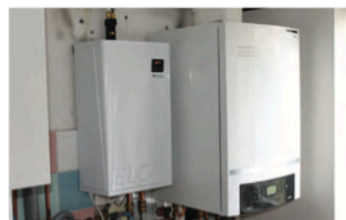
Hybride warmtepomp (links) met cv-ketel (rechts). Bron: Milieu Centraal.
