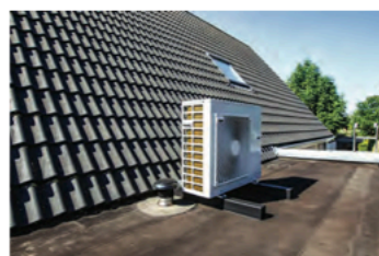
Buitenunit voor een hybride warmtepomp op het dak. Bron: NVL.
